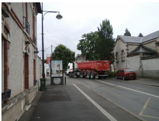
Entrée des camions sur chantier au N°112 pas de panneau de signalisation !
